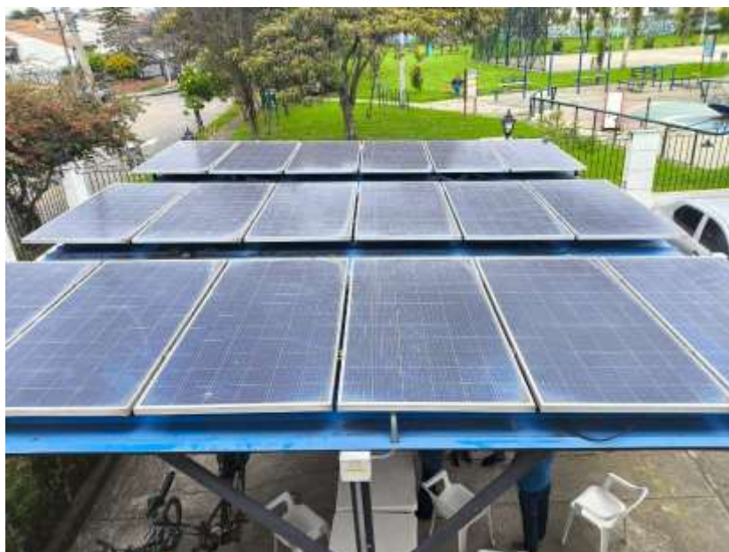
Sistema fotovoltaico – Sede casa las Villas ALS 2026.
