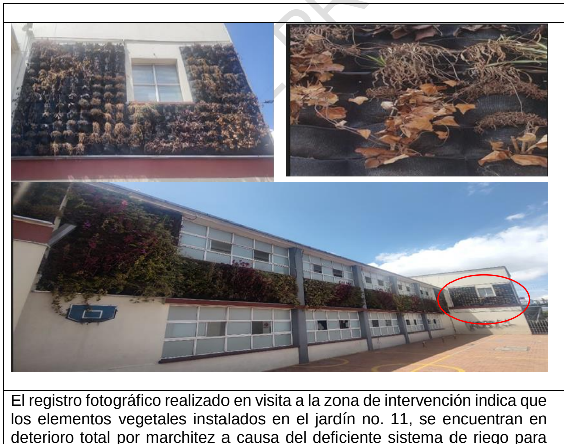
Cuadro 48. Registro fotográfico pérdida total material vegetal jardín “JV-CR-11”
