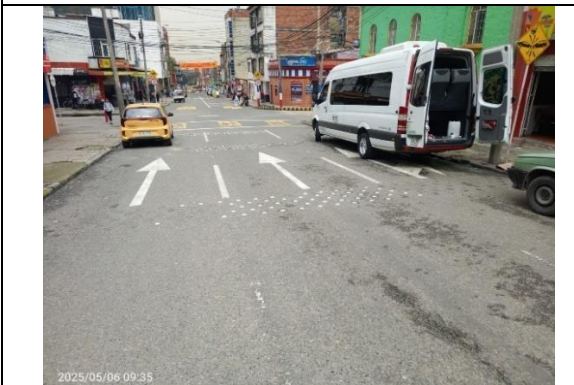
Observación No 1, CIV 2001917, Desprendimientos de material y desgaste prematuro de la calzada, frente al predio de placa 7-60.
