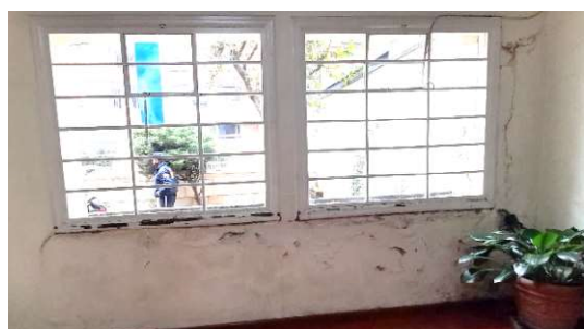
Fotografía 4. Muros con problemas estructurales y de humedad
